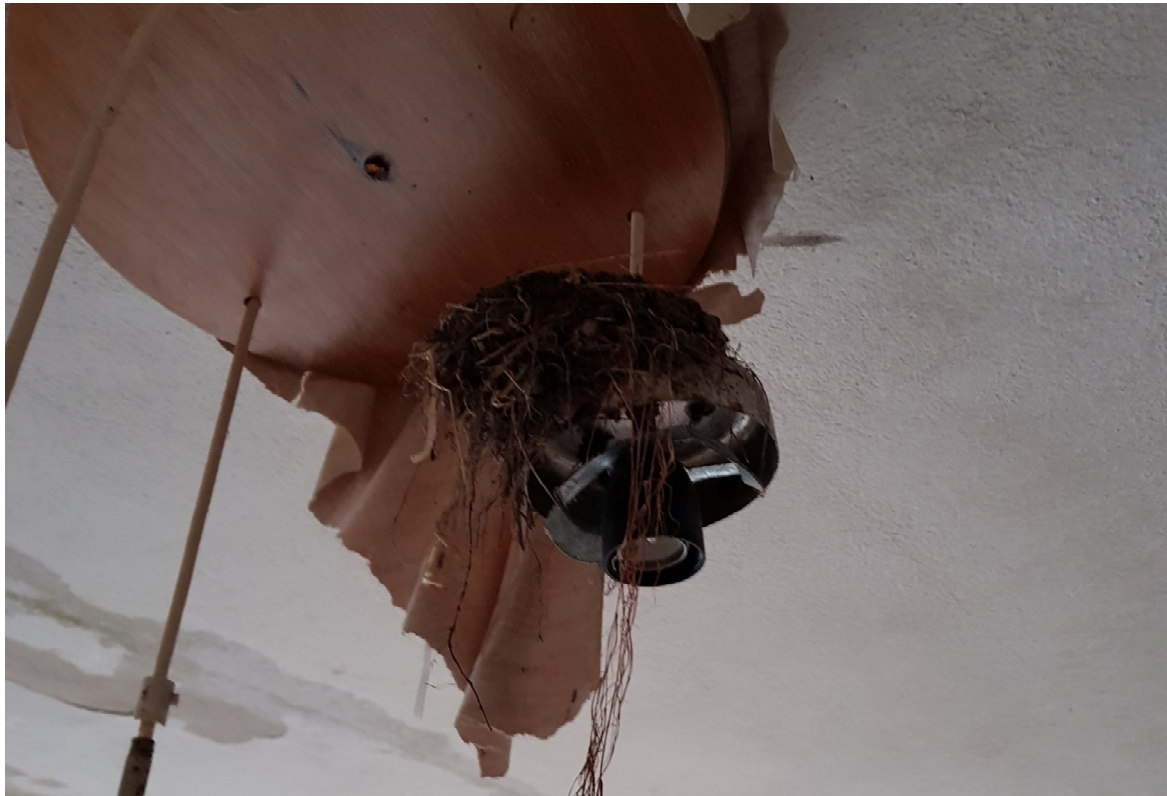
Abbildung 3: Schwalbennest auf den Resten einer alten Deckenlampe im Appartementhaus.
